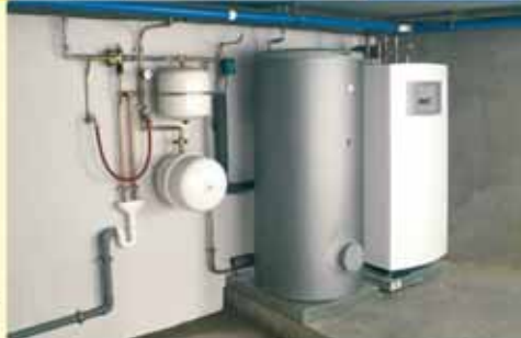
Erdwärmepumpen-Anlage (Foto Junkers)
